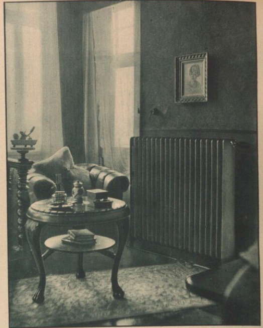
Etagenheizung in einer Altwohnung Der Heizkörper, in der Nähe des Fensters angebracht, ermöglicht eine gleichmäßige Erwärmung des Raumes
